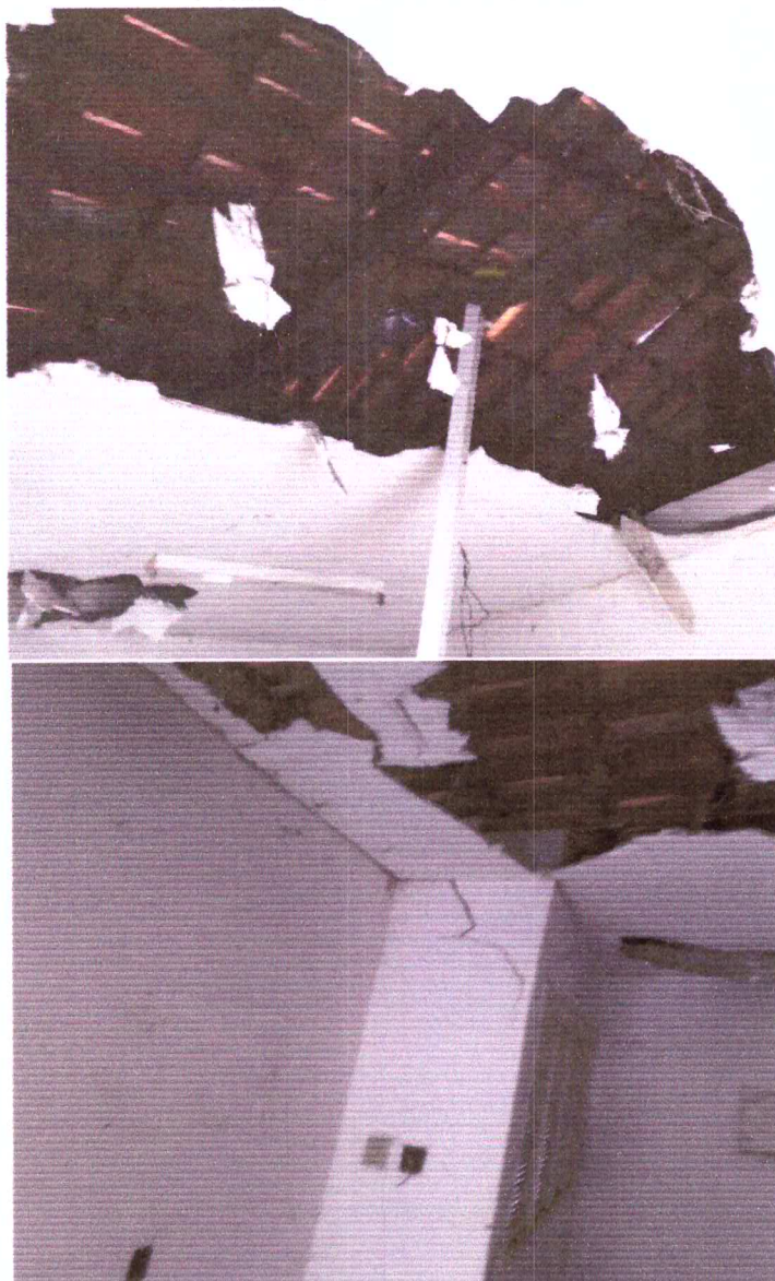
FORRO DE GESSO DANIFICADO
